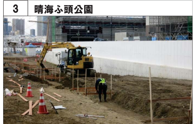
3 晴海ふ頭公園 再整備工事において、道路から公園内に入るためのスロープを設置しています。(港湾局工事)
